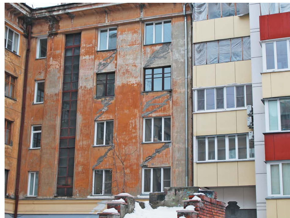
Проблемный дом на улице Урицкого, 17 в Новосибирске
