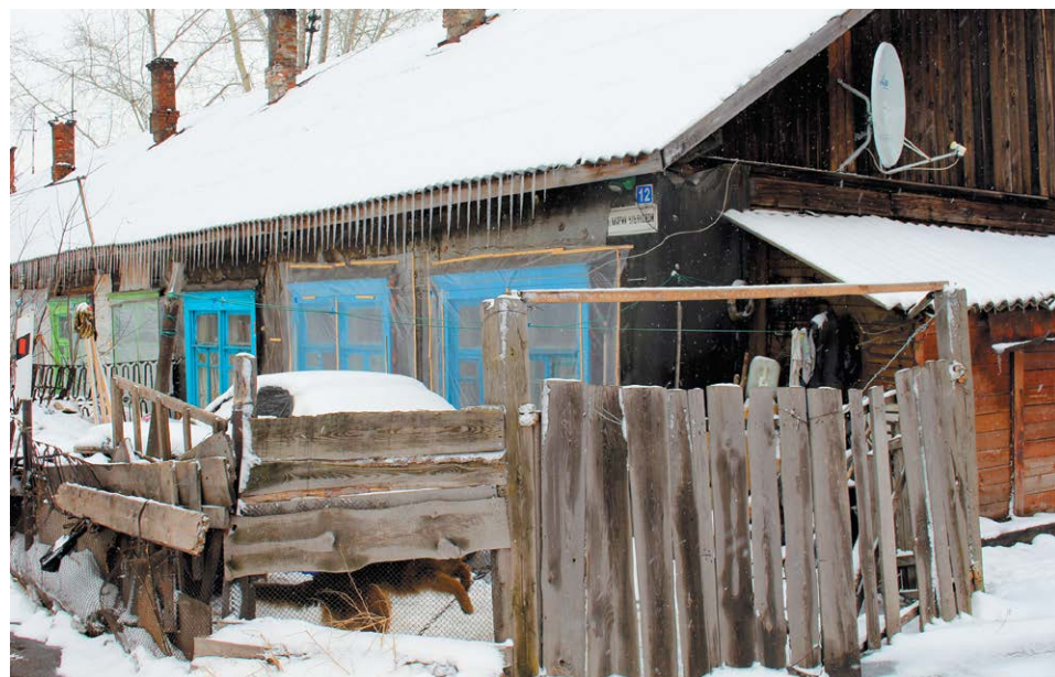
Аварийный дом на улице Марии Ульяновой, 12 в Первомайском районе
